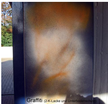
Graffiti (2-K-Lacke und Unterbodenschutz)
